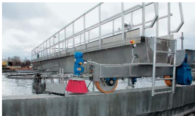
Новое оборудование обновленных вторичных отстойников
